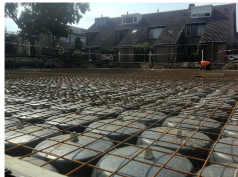
Het Watershell systeem is geplaatst en voorzien van wapening gereed voor stort betondek.
